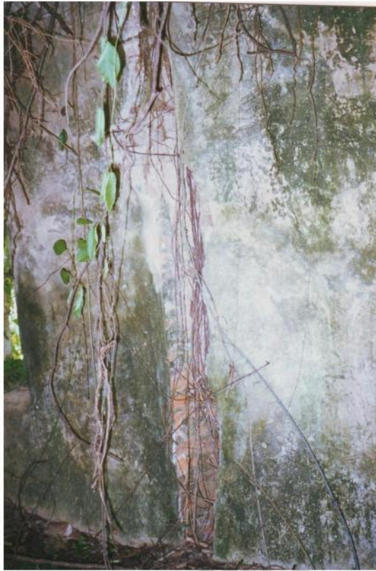
รอยเสาะไม้ บนผนังด้านทิศตะวันออก อุโบสถ วัดท่าช้าง (ร้าง)
