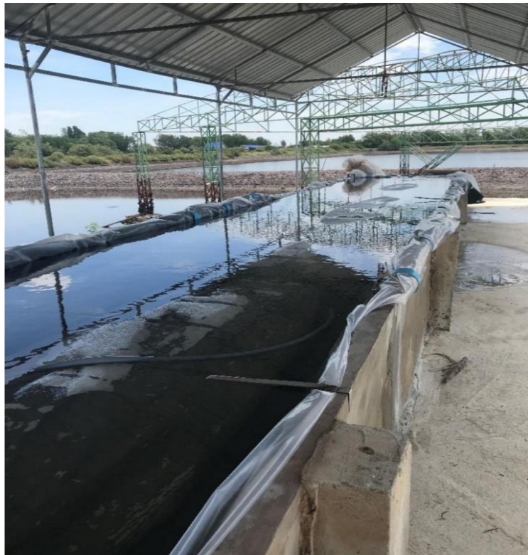
ภาพที่ 3-14-การเติมน้ำเข้าไปในบ่อซีเมนต์แช่ไม้ที่กระดุกงและเสากระโดงเรือหลังการปู่อซีเมนต์ด้วยพลาสติก
