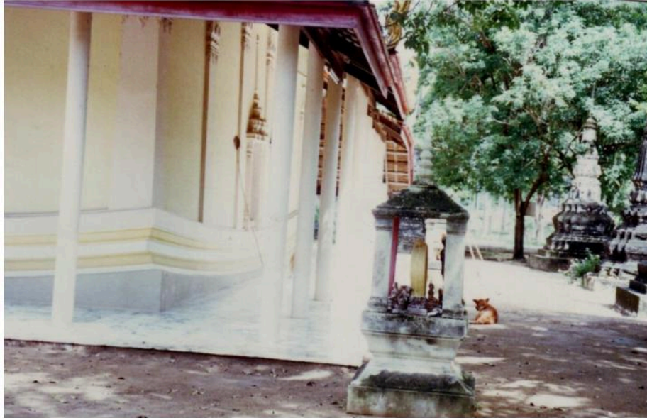
ฐานอุโบสถวัดโตนดหลวง มีลักษณะอ่อนโค้งมาก ตัวอุโบสถซ่อมแซมมาหลายครั้งแล้ว แต่ยังคงรูปแบบโครงสร้างเดิมไว้
