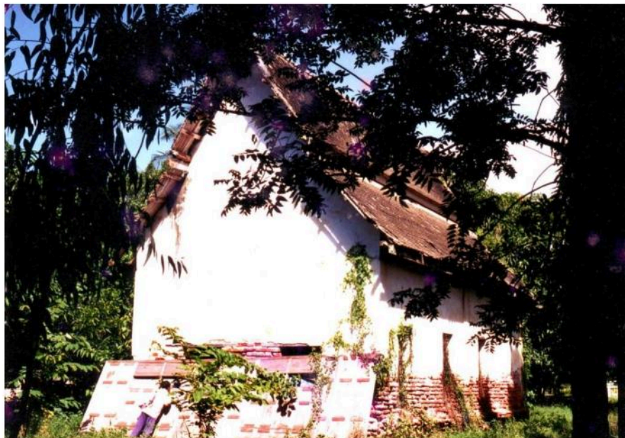
อุโบสถวัดหนองส้ม เป็นอาคารก่ออิฐถือปูน สภาพชำรุดมาก
