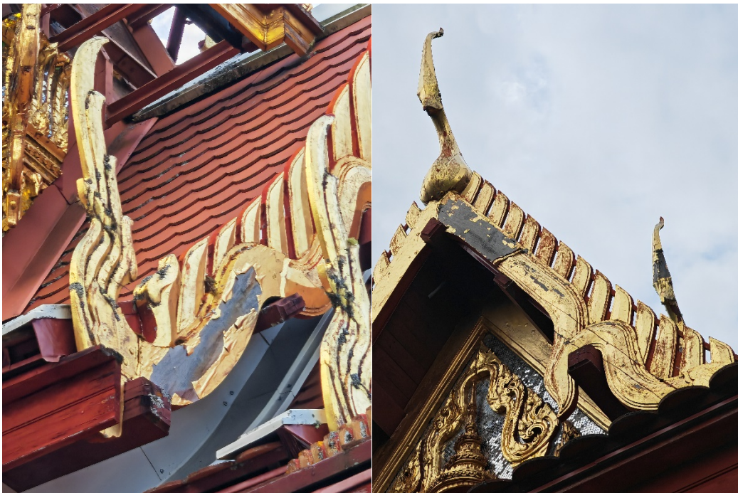
ภาพตัวอย่างความเสียหายของอาคารพระบรมราชานุสรณ์ พระบาทสมเด็จพระจุลจอมเกล้าเจ้าอยู่หัวในปัจจุบัน
